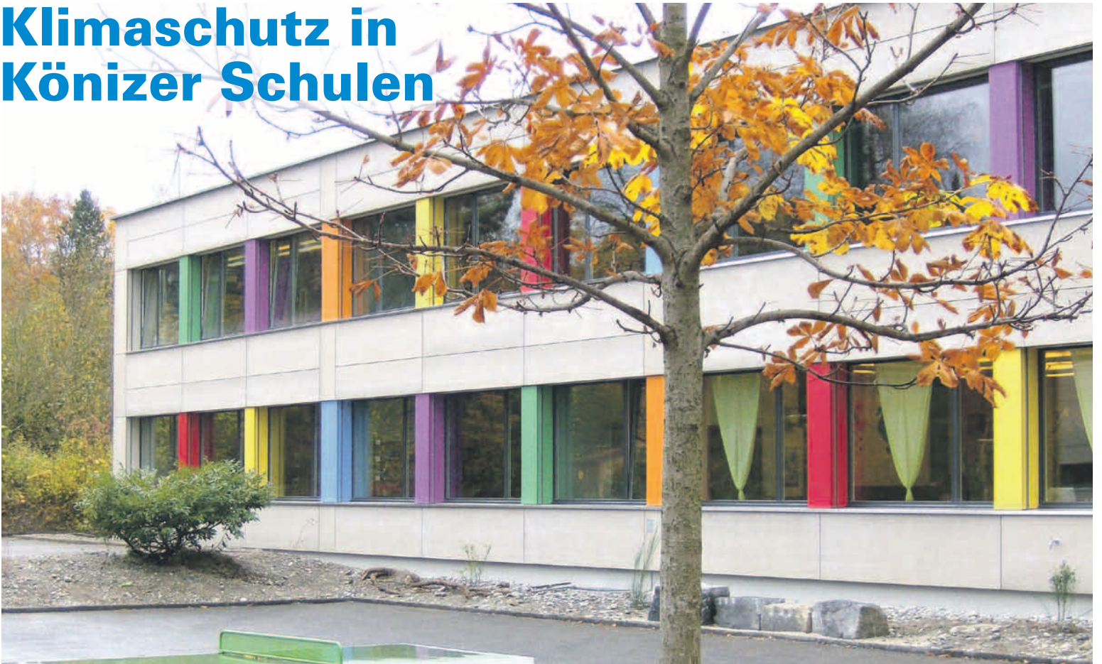
Die sanierte Gebäudehülle der Schulanlage Buchsee strahlt in freundlichen Farben und spart zehn Prozent Brennstoff ein.
