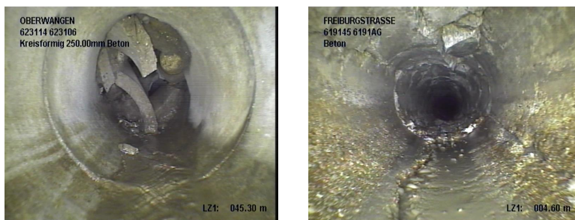
Abbildung 2: Bilder von Schäden, Dringlichkeitsstufe 0, Kanal-TV Untersuchungen 2017
