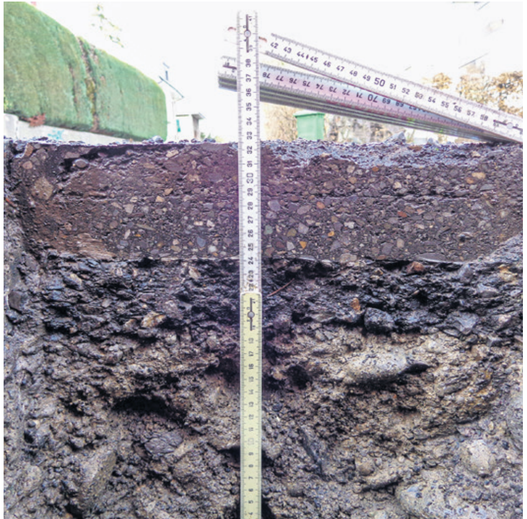
Strassenaufbau an der Eichholzstrasse mit Trag- und Deckschicht, einer Fundation mit dem Fachbegriff «Schottertränkung» wie sie vor Jahrzehnten eingebaut wurde. Mit ca. 20 cm liegt die Fundationschicht weit unter der heutigen Norm von 50 bis 70 cm.
