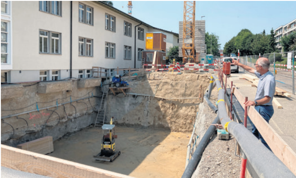
Die Wärmezentrale in der Schulanlage Buchsee am Lilienweg liefert ab September 2024 umweltfreundliche Wärme.
