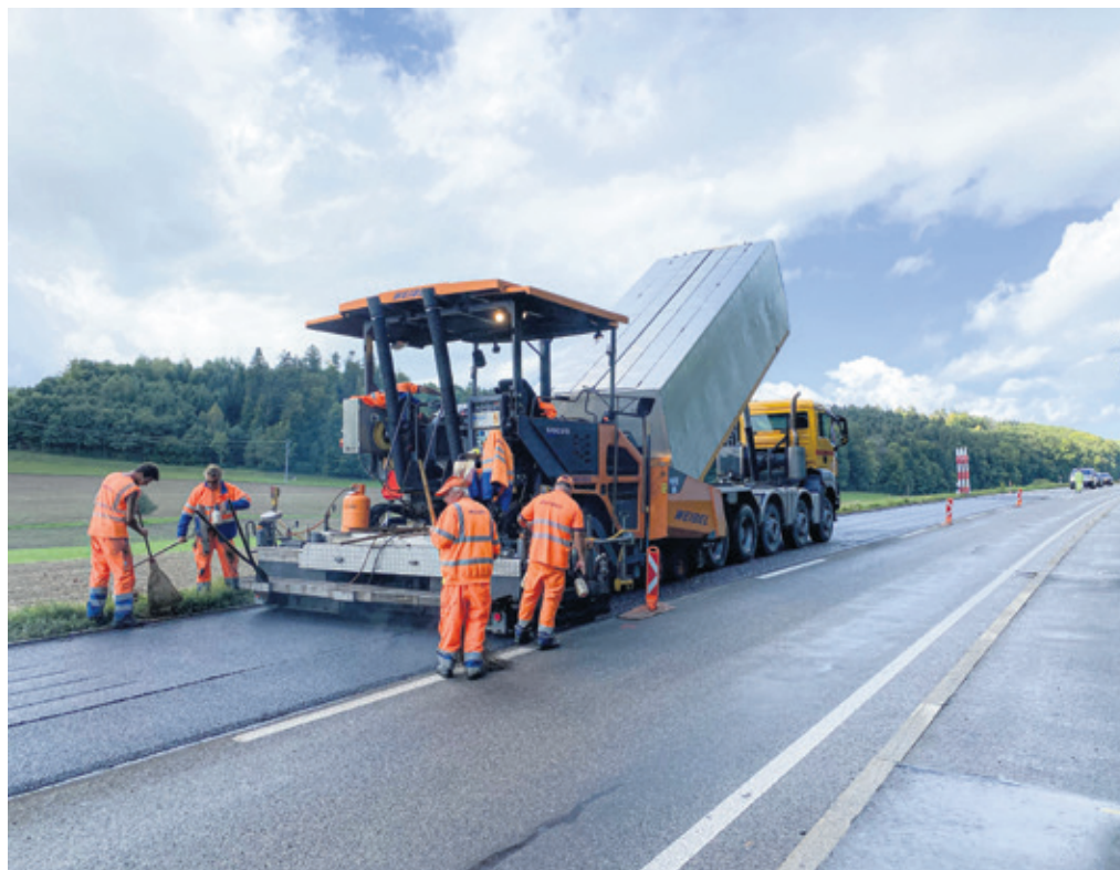
In einem Abschnitt der Landorfstrasse wurde im Jahr 2022 ein neuer Deckbelag eingebaut.
