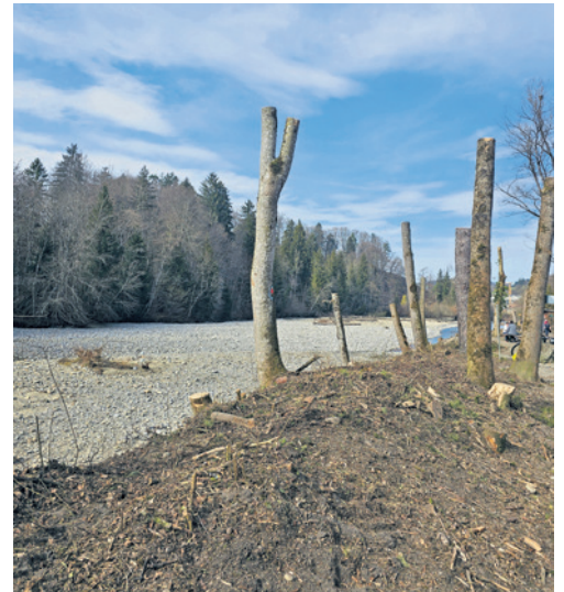
Wer würde ahnen, dass diese entasteten Bäume bald Fische beherbergen? Samt Wurzeln werden sie ins Wasser gelegt, als Fischunterschlupf und gleichzeitig wichtige Wasserbarriere. | Fotos: zvg
