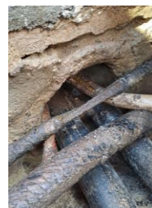
Abbildung 6: alte der Kabeltrasse.
