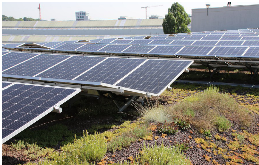
Abb. 8: Beispiel Solaranlage mit Dachbegrünung, Quelle: Zinco AG Schweiz
