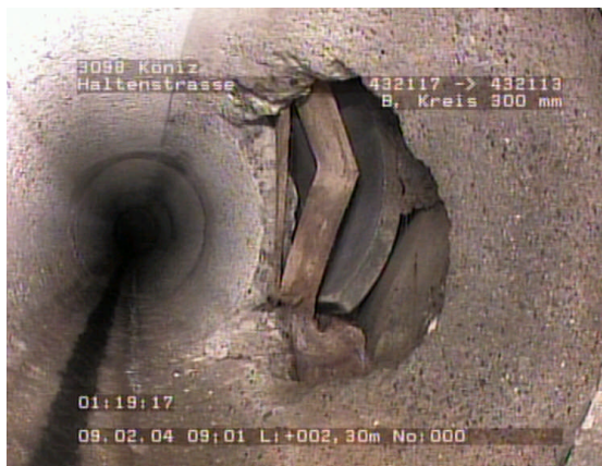
Loch in der Rohrwand
